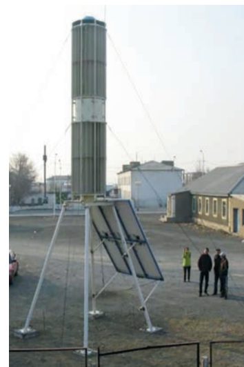
2006 год, КЭС ВРТБ-2,6 на объекте АО «Казактелеком», поселок Ажар, одновременно обеспечивает питание электронного оборудования школы
