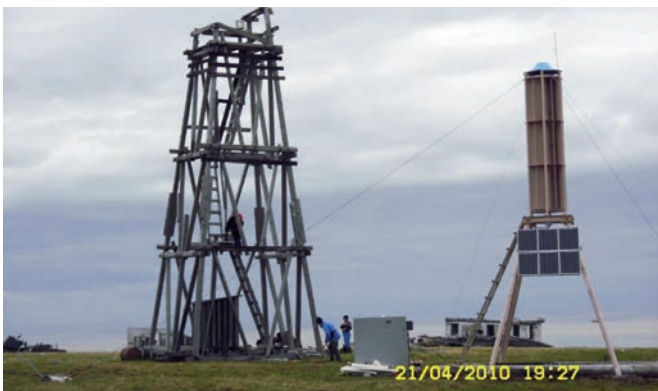
Маяк на мысе Челюскина, Северный Ледовитый океан. Техническое обслуживание КЭС ВРТЬ-2 Болотова, совмещенная с фотоэлектрическими панелями для светомаячной системы России
