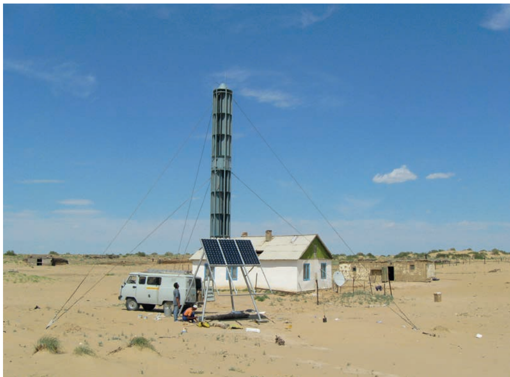
1996 год. Монтаж солнечно-ветровой установки для питания объекта поселка Кожаказган, Кызылординская область. Заказчик – АО «Казактелеком»
